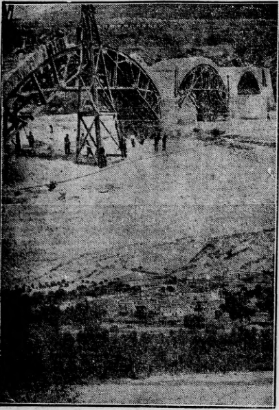
Con gran actividad se siguen en España, en la región de Almería, las obras de construcción de un notable puente que no deja de ser una bella obra de arquitectura. Cae de la pintoresca ciudad de Benimar, cuyo nombre huele todavía a árabe, y para la carretera de eBria, sobre el río de Adra se construye el mencionado puente cuyas obras pueden apreciarse en el grabado superior. Abajo: Benimar que va a resultar beneficiado con la nueva obra. Nos alegramos por los beninarenenses...
