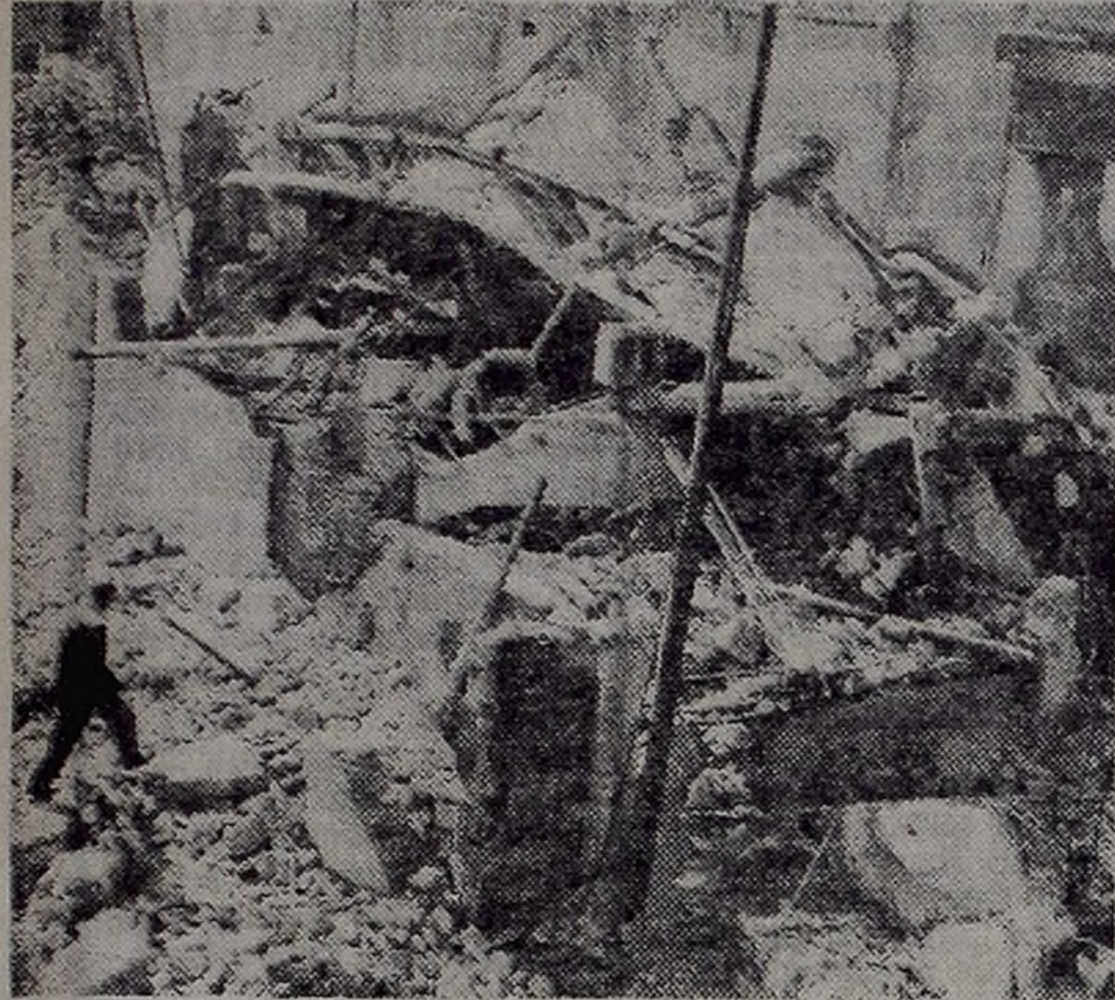
ESCOMBROS. Cinco obreros demolian la vieja finca de Lima 672 cuando ésta se derrumbó. Hay 3 heridos.
