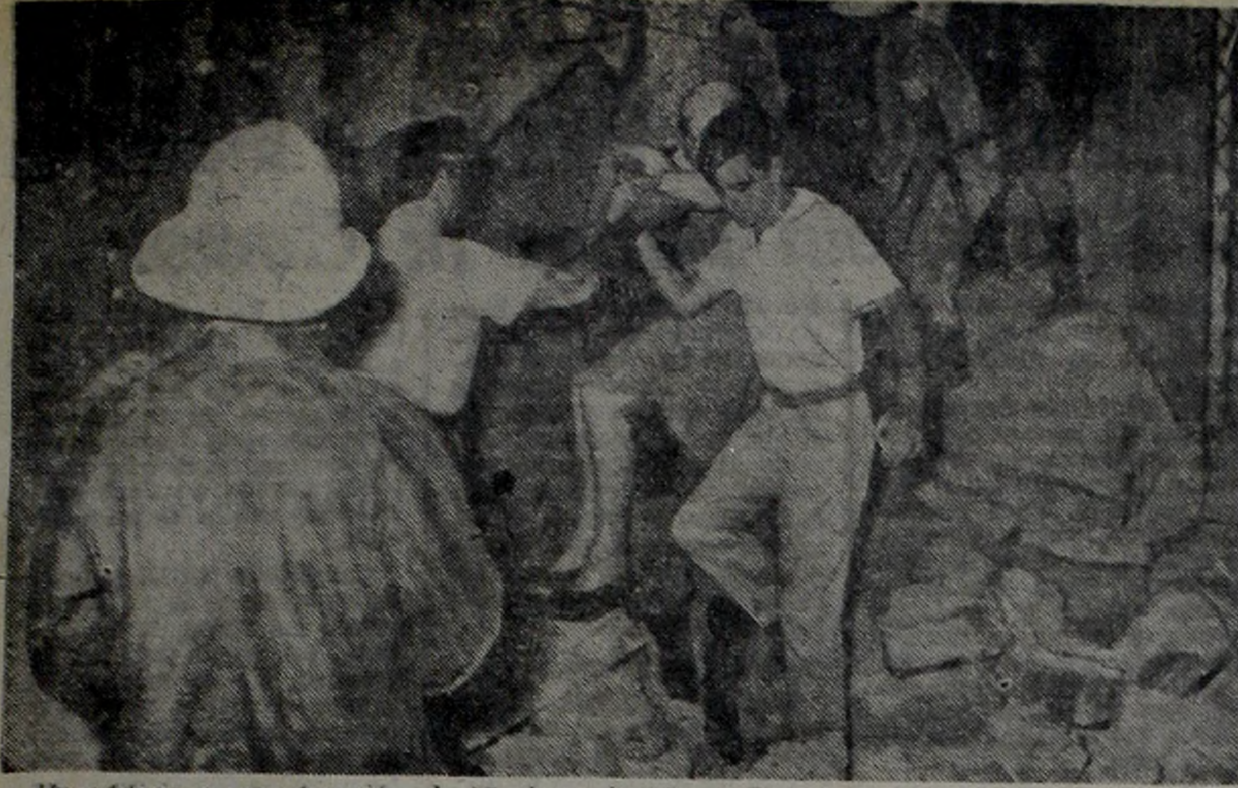
Un edificio en construcción, de 15 pisos, situado en French al 2800, se derrumbó. Los escombros bloquearon el acceso a una finca, cuyos ocupantes debieron ser evacuados.
