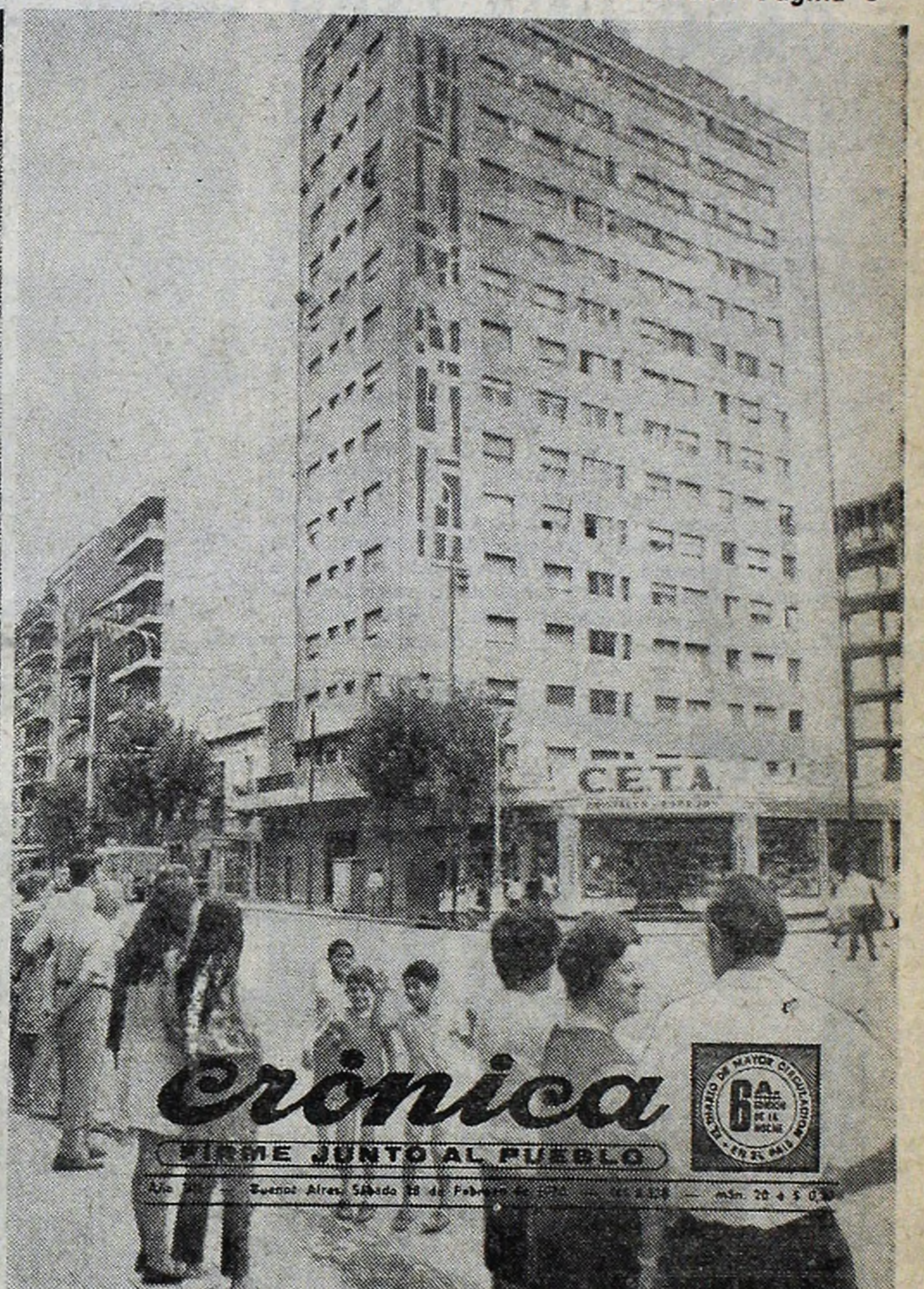
PELIGRO DE DERRUMBE. Varias columnas de un edificio de 15 pisos de la calle Montes de Oca se resquebrajaron. Los vecinos niegan el peligro. Pero la Dirección General de la Municipalidad ordenó su apuntalamiento. (Información pág. 7).
